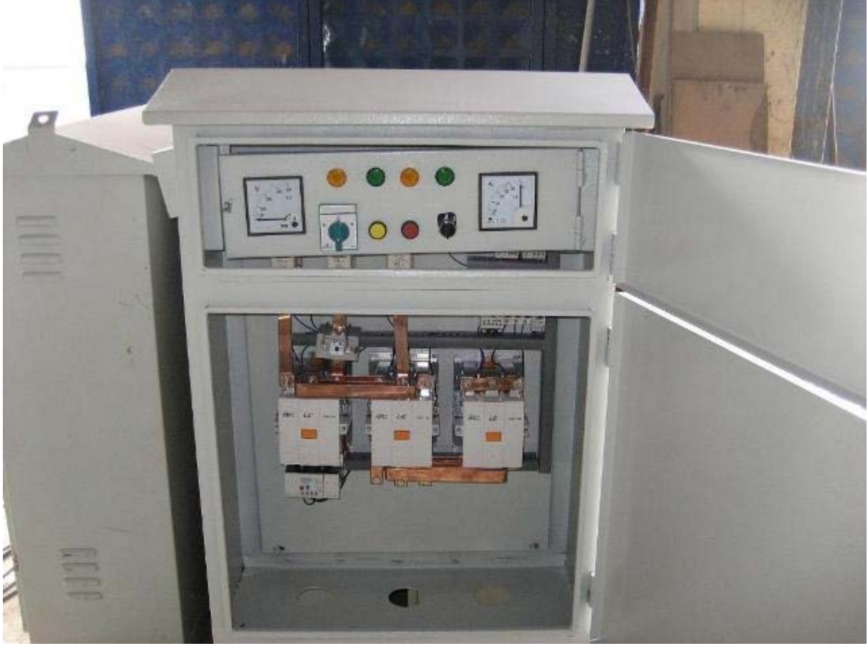
Şekil 38: Ceylanpınar'da Kullanılan Bir Trafo
