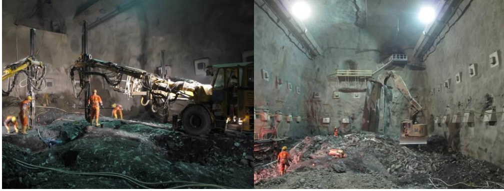
Şekil 13 – Yeraltı Kontrol Merkezi (Proje Machine 11, PSW Vianden)
